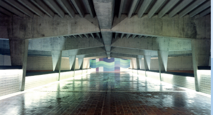
Filterhalle im Wasserwerk Granetalsperre
